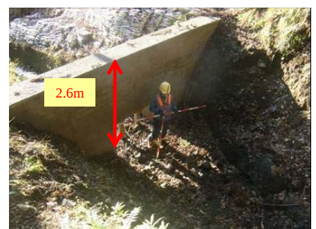
(写真－5 土砂堆積状況 (平成 24 年度))
