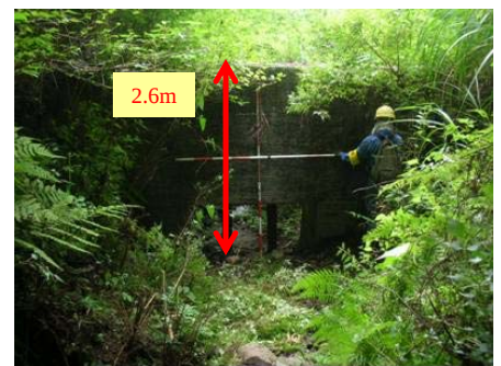
(写真－2 土砂堆積状況 (平成 18 年度))
