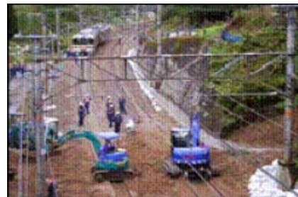
(写真-1 溪流災害現場)
