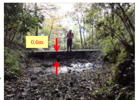
(写真－4 土砂堆積状況 (平成 22 年度))
