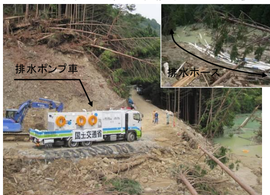
写真-5 上池排水状況
