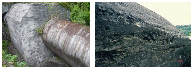
写真-1 1号固定台外観（左：全景、右：劣化状況）
