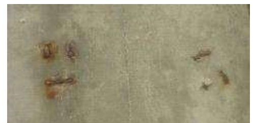
写真－3 露出鋼材の腐食状況
