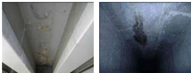
写真-2 表面塗装の劣化
