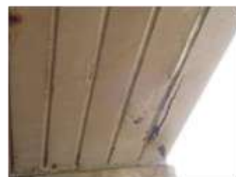
写真-1 再劣化時の損傷
