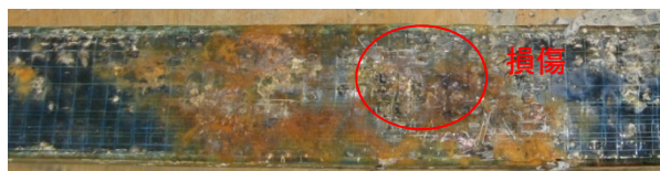
写真-1 炭素繊維シートの損傷状況
