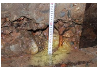
(a) 12L/分の漏水場所
