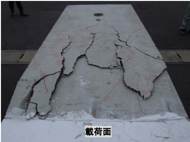
写真-2 B0-1 破壊状況（上床版）
