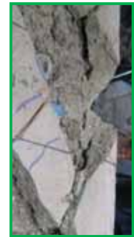
+0.0460rad かぶり剥離
