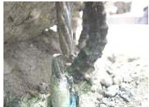
図-7 P C 鋼棒破断状況
