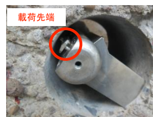
写真 1 孔内載荷試験装置
