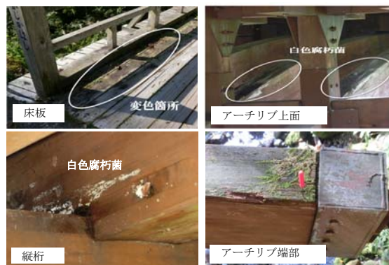
図-2 目視試験による腐朽箇所の一例
