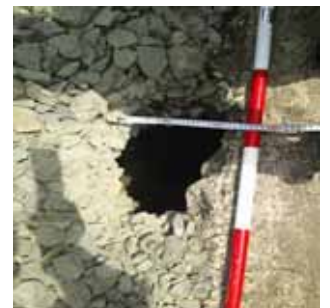
図-3 5月中旬に発生した陥没
