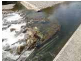
図-5 破損している落差工
