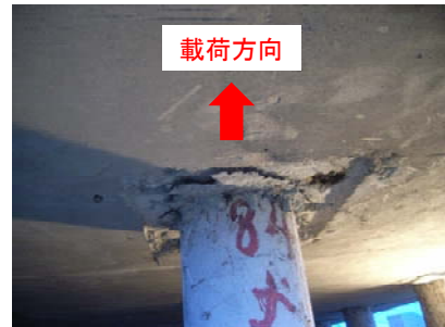
写真 2 載荷後の杭頭部破壊状況
