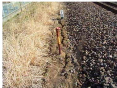
写真-1 亀裂被害例
