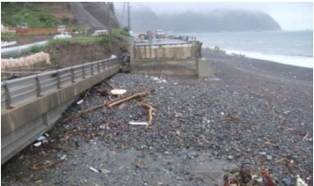
写真－1 被災後の対象橋梁
