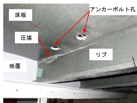
写真-1 ウェブの損傷状況(補強板撤去)
