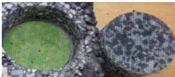
写真-2 界面破壊状況
