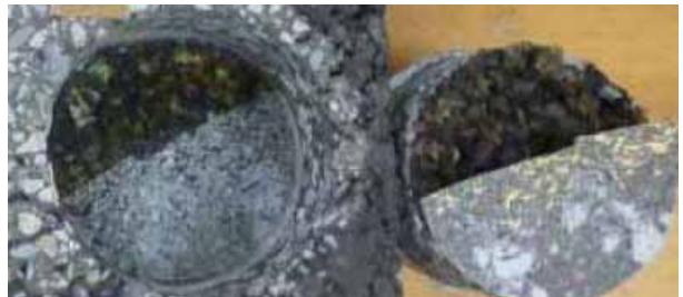
写真-3 アスファルト、コンクリート母材破壊状況
