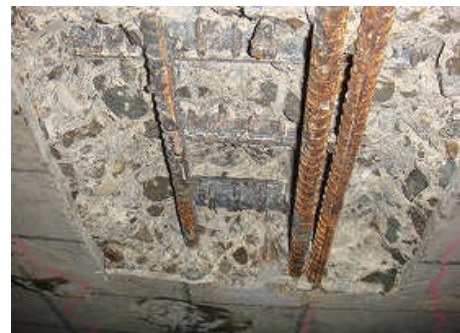
写真—2 鉄筋の腐食状況
