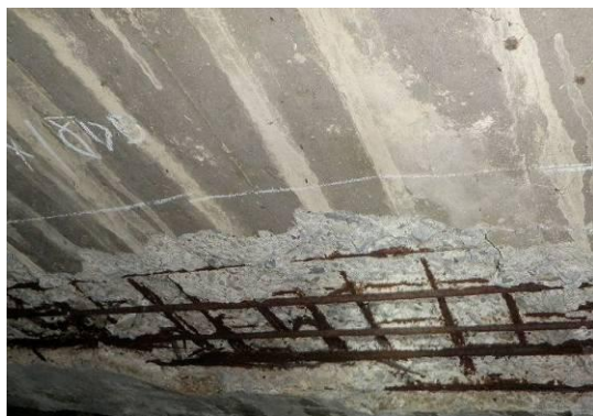
図-1 床版に発生した損傷例
