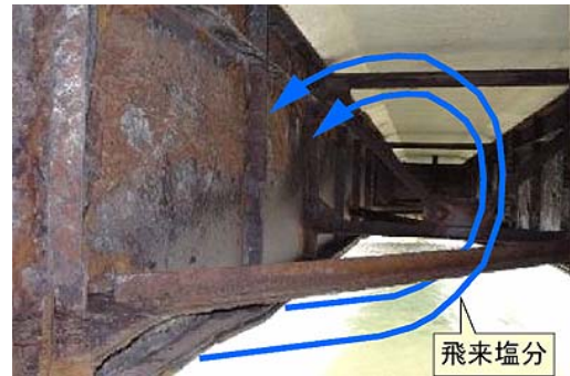
図-1 B橋の桁内面側の腐食状況
