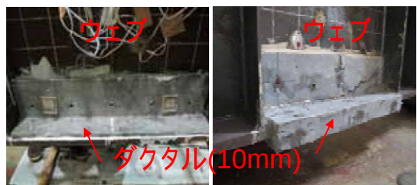
c)下部欠損+ダクトル補修 d)下部欠損+ダクトルギブス補修
