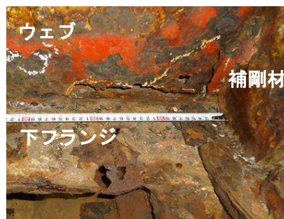
写真-1 桁端部の腐食状況
