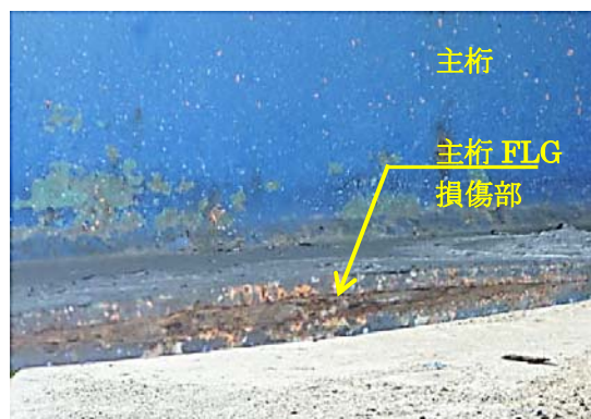
図-2 損傷状況（定期点検時）
