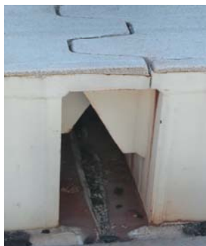
写真-1 フィンガージョイント接触状況
