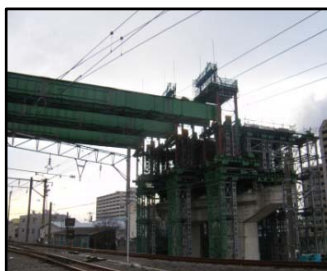
写真-2. 撓み処理設備
