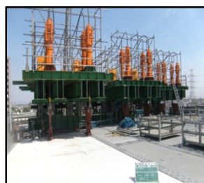
写真-5. 油圧降下装置
