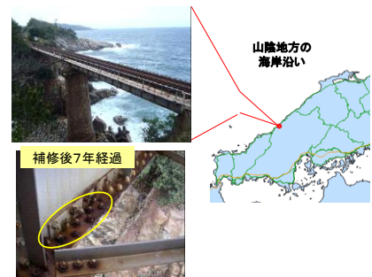
写真 1 高力ボルト早期腐食事例
