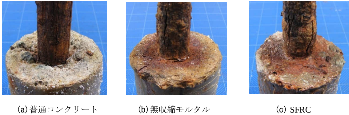
図4 地際部の腐食状況
