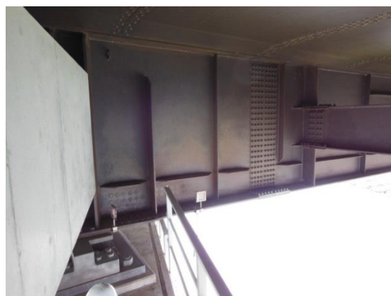
写真 1 朝酌川橋梁の桁内鋼板の状態
