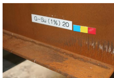
写真 - 2 剥離の様子
