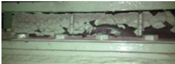
図1 LRBの経年劣化による損傷
