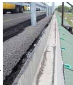
写真-2 地震による排水工のずれと舗装との間に生じた隙間
