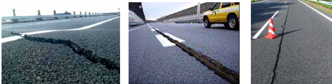
写真-1 代表的な舗装の被災事例（左：北関東道の裏込め部の横断亀裂、中・右：京葉道と常磐道の施工目地部の縦亀裂）
