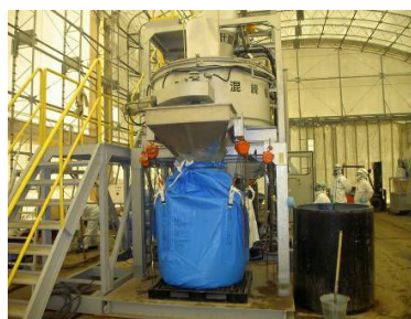
写真-1 セメント固型化処理設備
