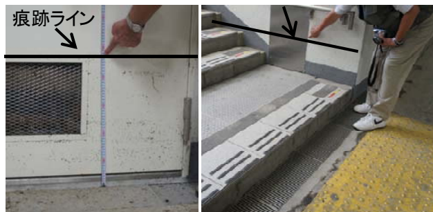
写真-1 JR高蔵寺駅地下道浸水痕跡(被災3日後)
