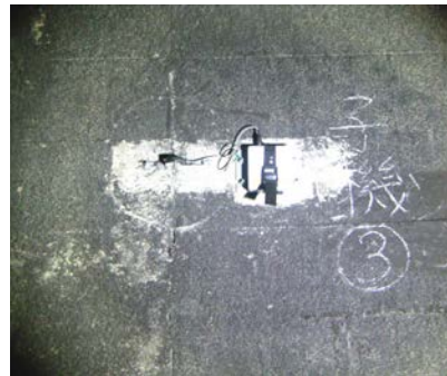
(a) 子機の設置状況
