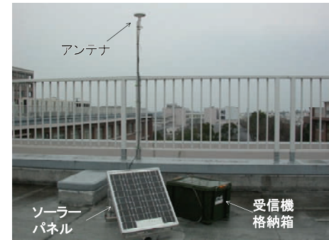
図-1 変位計測センサー
