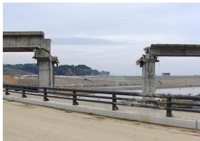
写真-1 東日本大震災による津波被害
