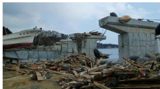
Fig.1 津波被害による落橋被害(2011.3.11)
