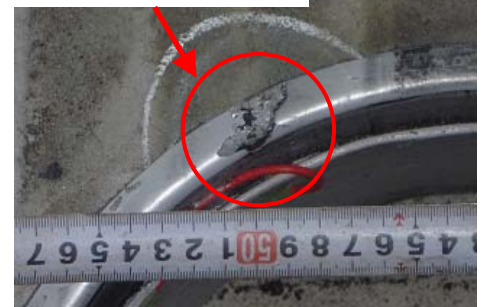
図-5 FRP 上端の損傷状況
