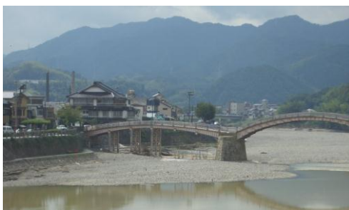
写真-4 2005 年の台風後の錦帯橋
