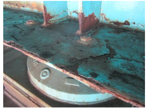
写真-3 桁端部の腐食損傷
