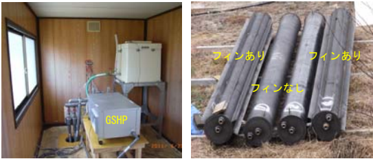
(a) GSHP (b) 地中熱交換器
