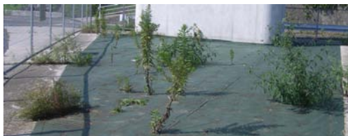
写真1 留め具の隙間から雑草が生育している防草シート（5年経過）
