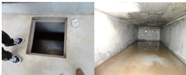
写真-2. 雨水貯留タンク
