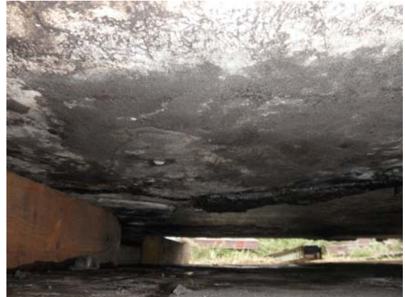
図-2 スラブ板下面の状態
