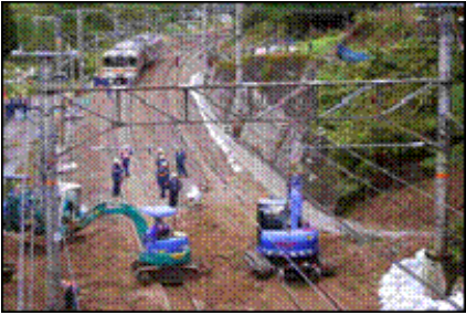
図 1 H16 中ノ沢橋りょう 土砂流入
