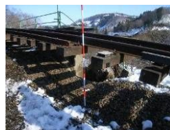
写真-1 橋台背面道床沈下
