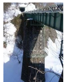
写真-3 1P 亀裂
