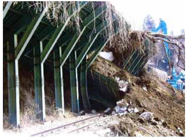
写真-3 なだれ止め柵被災状況
