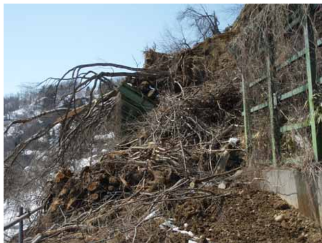
写真-2 なだれ止め柵、落石止め柵被災状況
