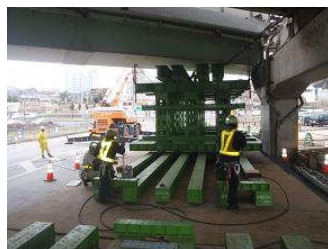
写真3 ベント引込み
