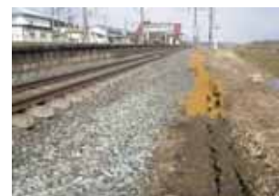
図-4 (左)被害状況
