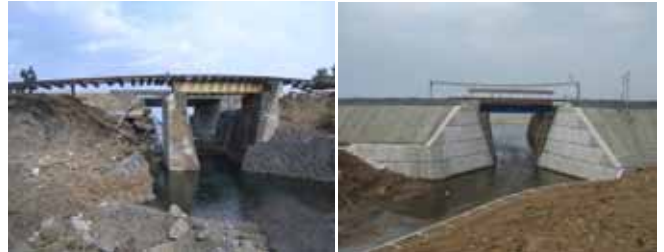
図-8 八木川橋りょう(左)被害状況 (右)復旧写真
