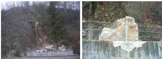
図-7 被害状況写真
