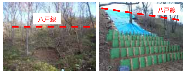
図-10 (左)被害状況写真 (右)復旧写真
