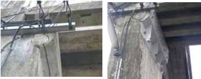
図-5 山ノ目駅 (左)被害状況 (右)復旧写真
