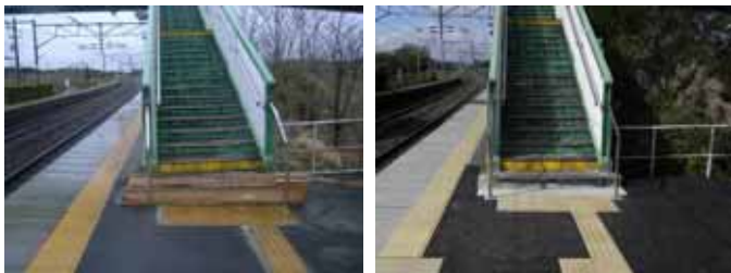
図-6 清水原駅(左)被害状況 (右)復旧写真
